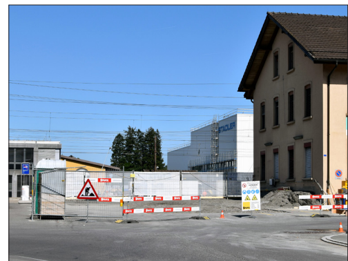
Die Bauarbeiten für die neue Fussgänger- und Veloüberführung haben im September begonnen
