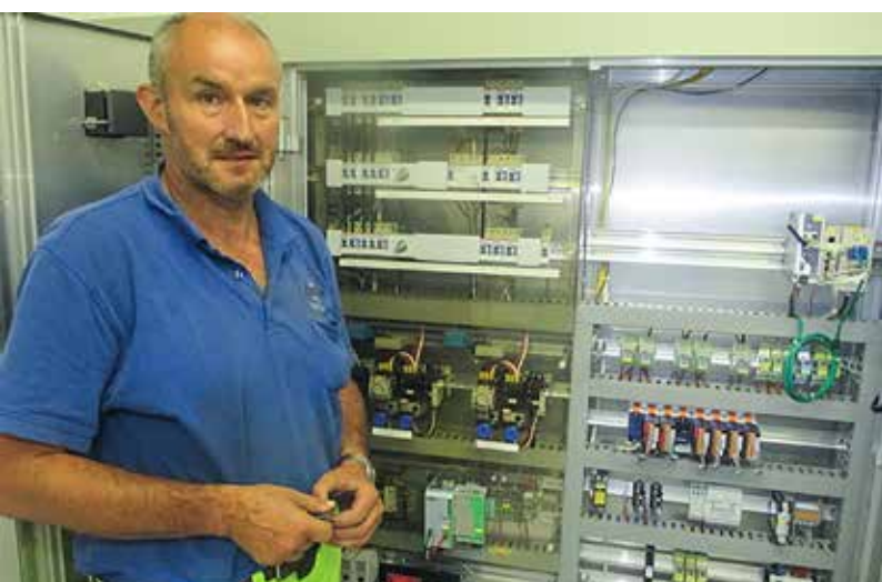
Das Reservoir Weid und dessen Steuerungszentrale sowie alle weiteren der Wasserversorgung dienenden Einrichtungen kontrolliert Wasserwart Peter Schmid regelmässig.
