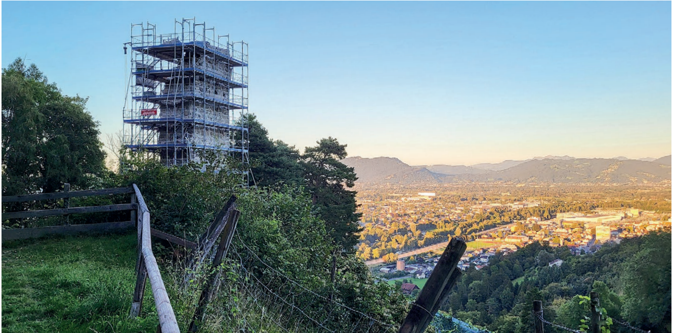
In zwei Sanierungsetappen wird die Burgruine Grimmenstein zu einem sehr attraktiven Naherholungsraum gestaltet.
