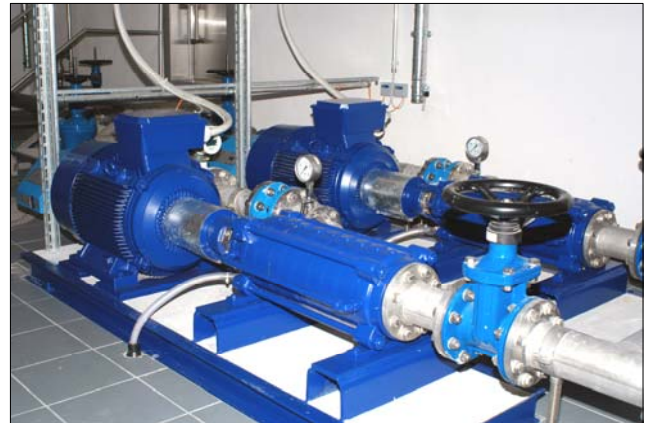
Seit September 2009 ist das neue Pumpwerk im Reservoir Käsgaden im Einsatz
